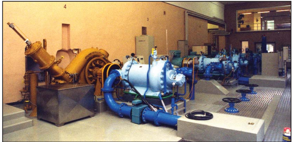
Turbopompe, avec en arrière plan les moteur-pompes électriques.
