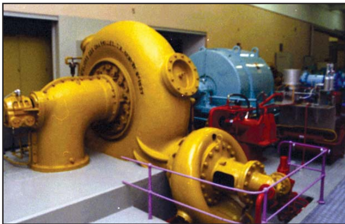
Groupe turbine-alternateur de 1750 kVA.
