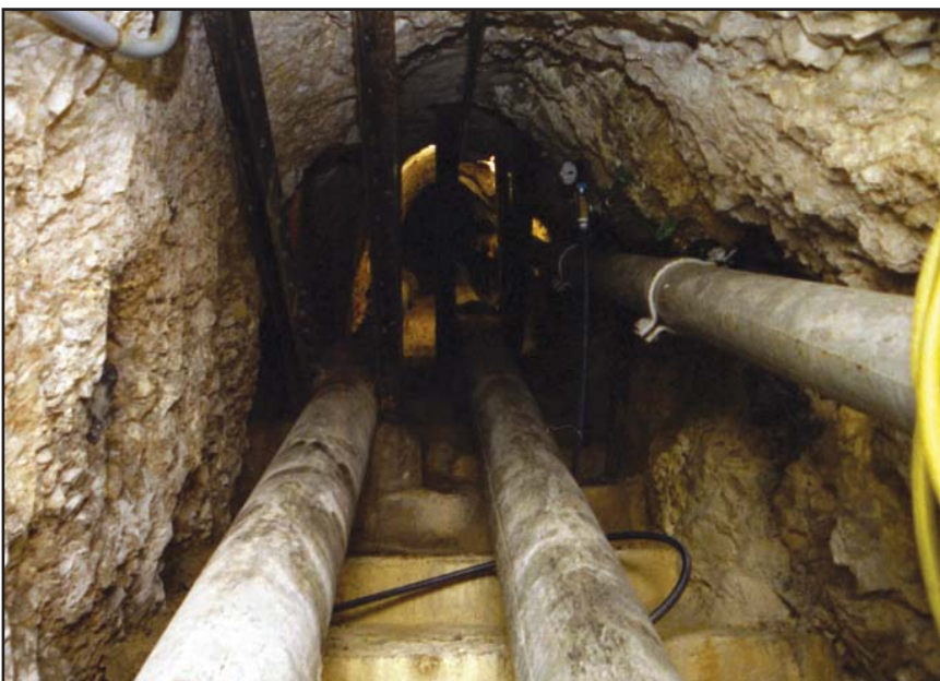
Départ des conduites d'eau potable en direction du Tunnel de Jogne.
