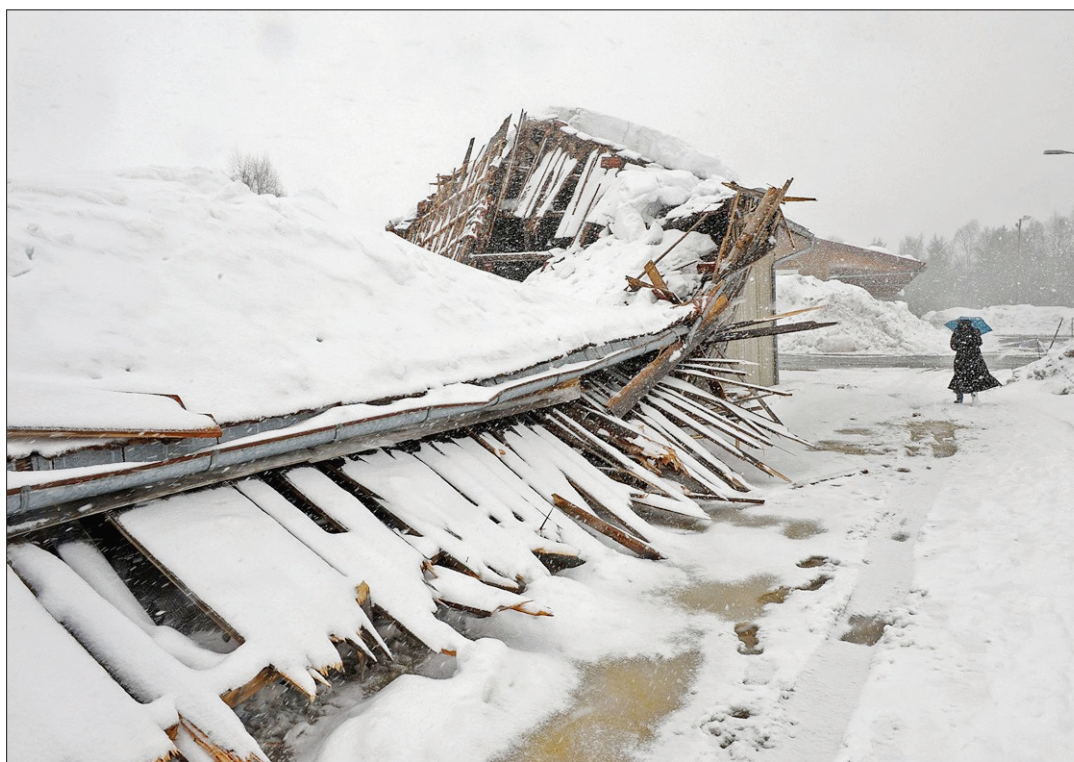
LES PONTS-DE-MARTEL Le toit de ce hangar de 25 mètres sur une douzaine s'est écroulé sur une vingtaine de véhicules dont il ne reste pas grand-chose. Heureusement, il n'y avait personne. (CHRISTIAN GALLEY)
